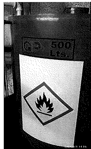
Tanque 500 Litros Diésel, para planta de emergencia.
