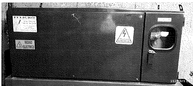
Transformador y medidor. Gabinete para equipo de medición tipo pedestal para distribución subterránea.
